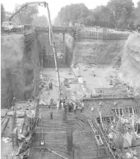
写真25 デリーメトロ1期 地下鉄土木工事 MC1A工区開削工事 駅部（JICAご提供）
